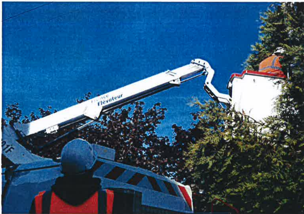
Deux techniciens viennent d'installer des boîtiers de raccordement de la fibre près des maisons situées au lieu-dit la Rougeollière.
