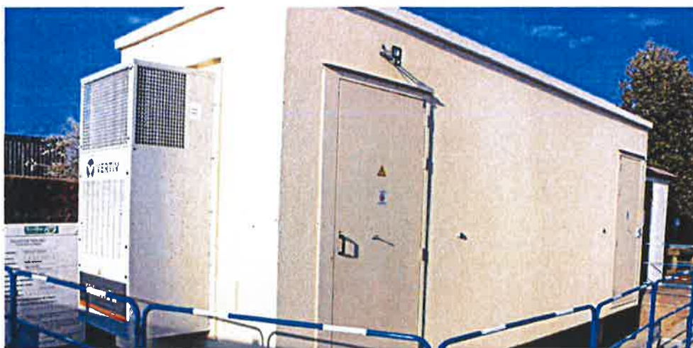
Ce grand caisson est un NRO, une sorte de gare de triage pour les flux d'information véhiculés sur la fibre optique.
