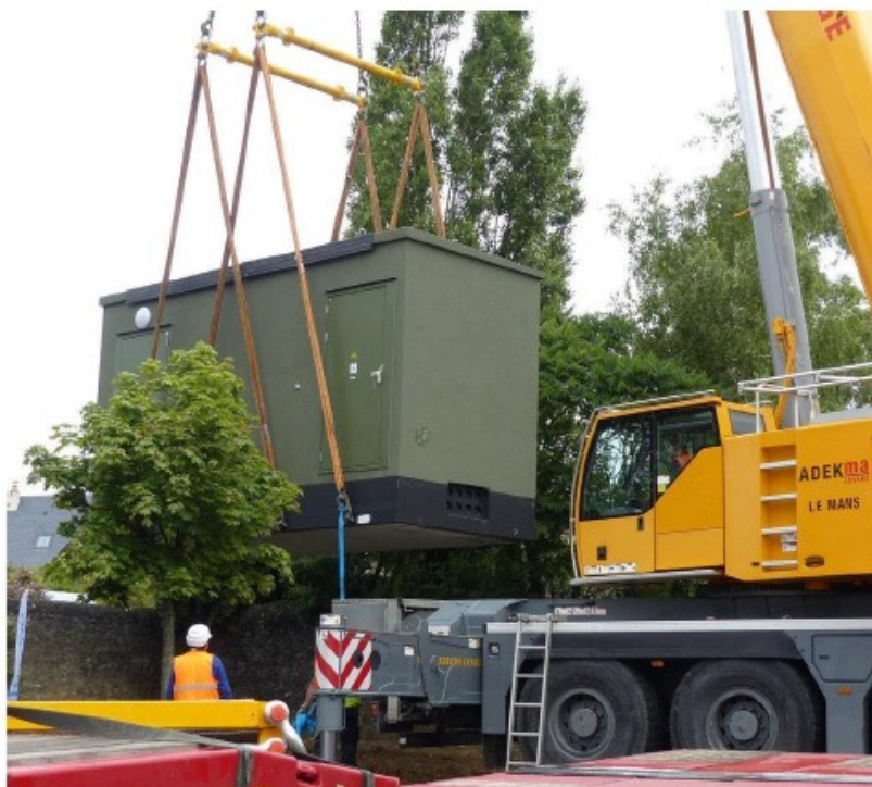
Le dernier noeud de raccordement optique de la Sarthe a été installé à Auvers-le-Hamon. Bientôt l'ensemble du département pourra avoir accès à des connexions Internet via la fibre optique.
