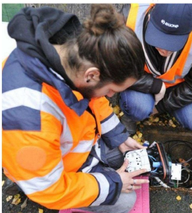
Le déploiement de la fibre avance en Sarthe. (©Illustration CD72)
