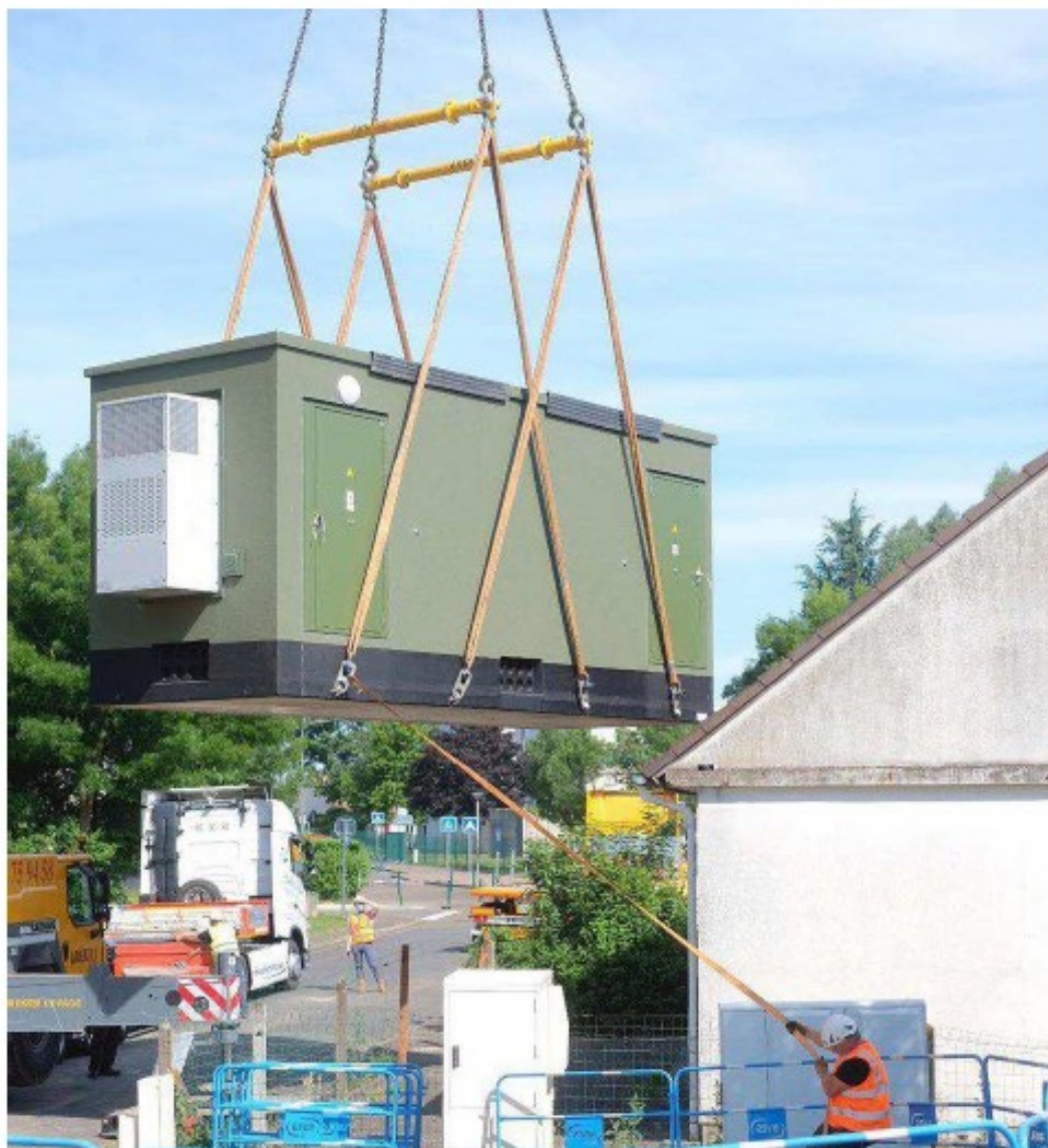
Le nœud de raccordement optique est déposé par une grue. Il sera connecté au réseau fibre.
